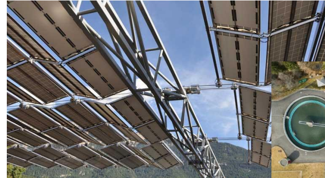
Beispiel: Faltdach der Kläranlage ARA Chur
