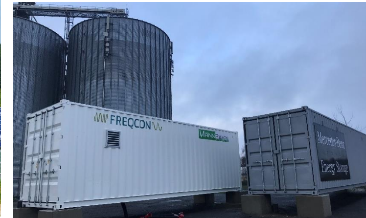
Großbatterie als Containerlösung bei der Westerwälder Holzpellets GmbH
