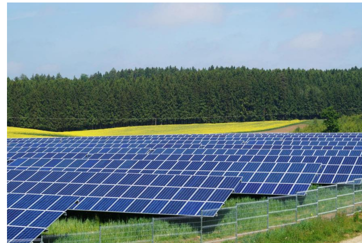
PV Freiflächenanlage als kostengünstige Erzeugungsmöglichkeit
