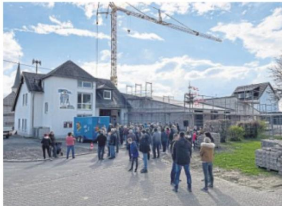
Zahlreiche Ehrengäste und Bürger nahmen am Richtfest für den neuen Gebäudekomplex teil. Foto: Gemeinde Büchel/Christian Sieling
