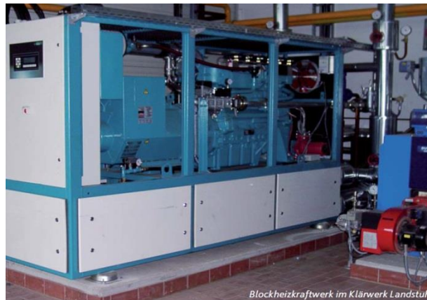
Blockheizkraftwerk im Klärwerk Landstuhl
