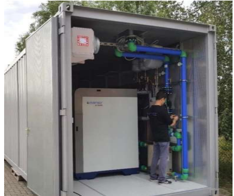
Blick in einen InvenSor Container
