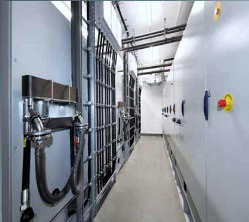
9 DC/AC Wechselrichter - 1MW - wassergekühlt
